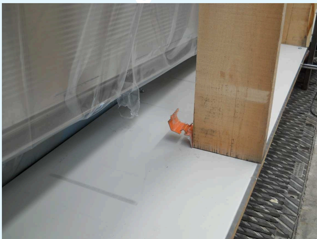
Particolari di rottura.
